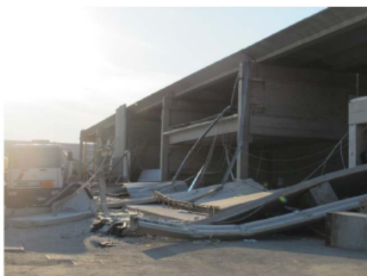
Figura 42 –Collasso pannelli verticali di tamponatura di un edificio prefabbricato
