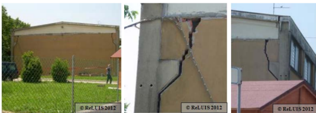
Figura 46 – Perdita di verticalità dei pilastri in un edificio monopiano prefabbricato per possibile, ma non accertato, problema a livello della fondazione
