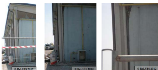
Figura 48 – Perdita di verticalità del pilastro con fessurazione alla base
